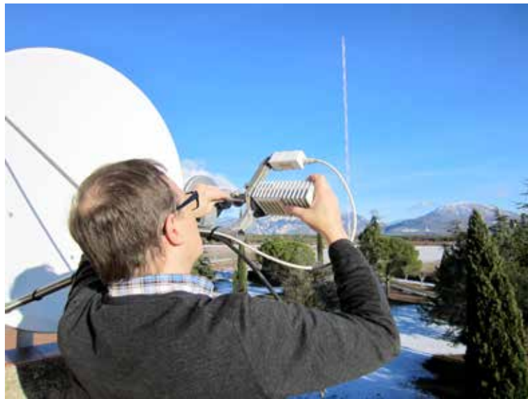
Jari päivittämässä satelliittilaitteistoa lähettinasemalla.
